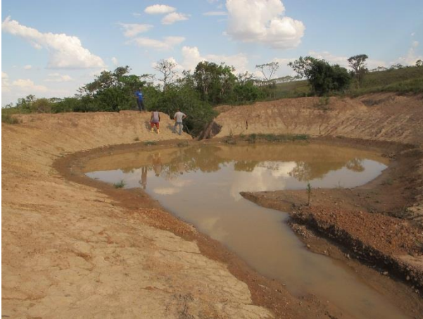
Foto 19: Vista da barraginha rompida à montante da nascente. (Coord. UTM 515519 / 7953903)
